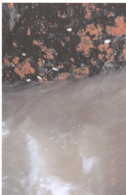
照片3 A、B、C 桩水区外侧 涂层电位: -886 mV( 0 m) -902 mV( -1 m) -906 mV( -2 m) -910 mV( -4 m)
