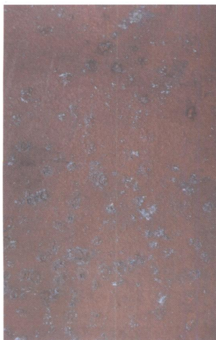
照片 9 F、G 桩大气区内侧有机涂层破裂区 涂层厚度: 234 \mu\text{m}
